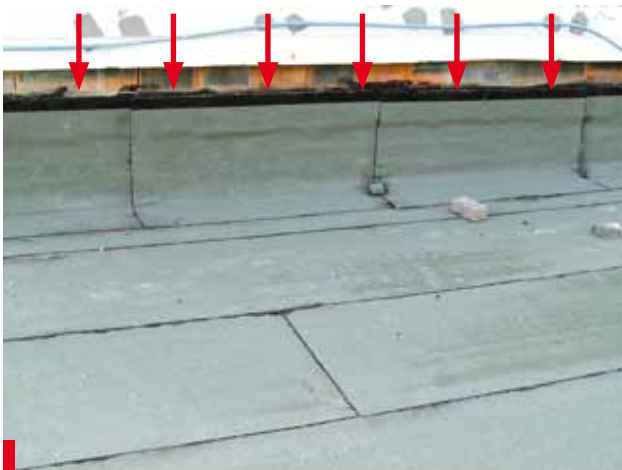
Fot. 15. W przypadku obróbki z papy nawierzchniowej (np. korzenioodpornej) zgrzewanej „poziomo” traci się również możliwość uszczelnienia zakładów na pasie do tego przygotowanym, tj. wolnym od posypki
