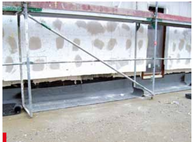
Fot. 14. Próba wykonania obróbki dekarzkiej z papy zgrzewanej na ścianie w kierunku poziomym zawsze kończy się źle, ponieważ w trakcie zgrzewania dekarz traci kontrolę nad materiałem
