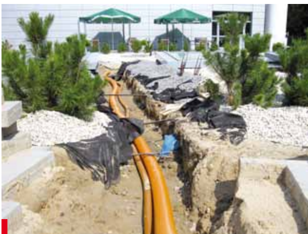
Fot. 25. Pominięcie drenażu stanowi chwilową „oszczędność”, ponieważ późniejsza próba założenia drenażu na dachu zabudowanym jest zdecydowanie kosztowniejsza i raczej nieskuteczna
