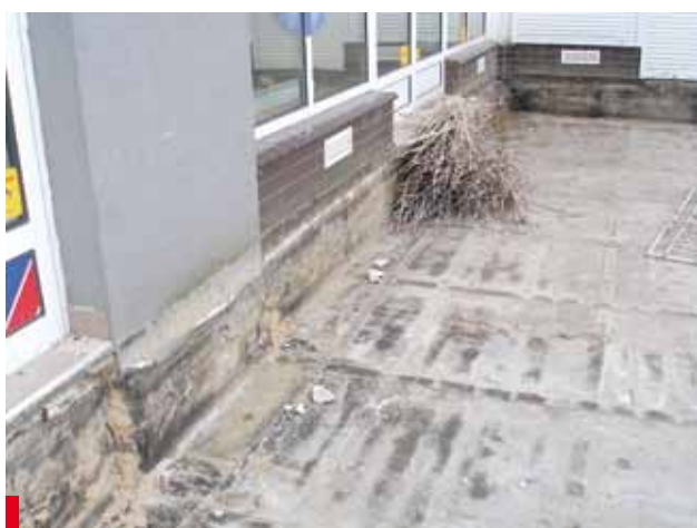
Fot. 11. Po rozbiórce nawierzchni odsłonił się problem — obróbka z papy na ścianie budynku została zakończona poniżej poziomu nawierzchni z kostki betonowej
