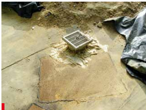
Fot. 18. Taki „wynalazek” na tarasie w XXI wieku kompromituje całą budowę
