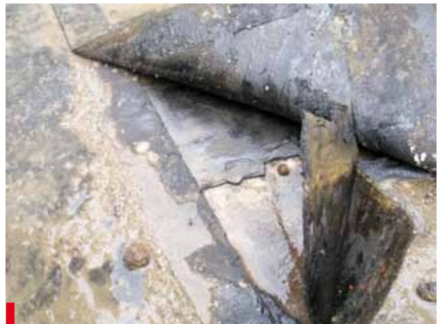
Fot. 6. Wbrew pozorom zawiódł wykonawca, a nie materiał – ponieważ zastosował papę o podrzędnych parametrach technicznych do hydroizolacji tarasu
