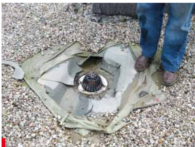
Fot. 19. Wykonawca nie rozumie znaczenia „szczelność” i tym samym jego praca nie ma sensu
