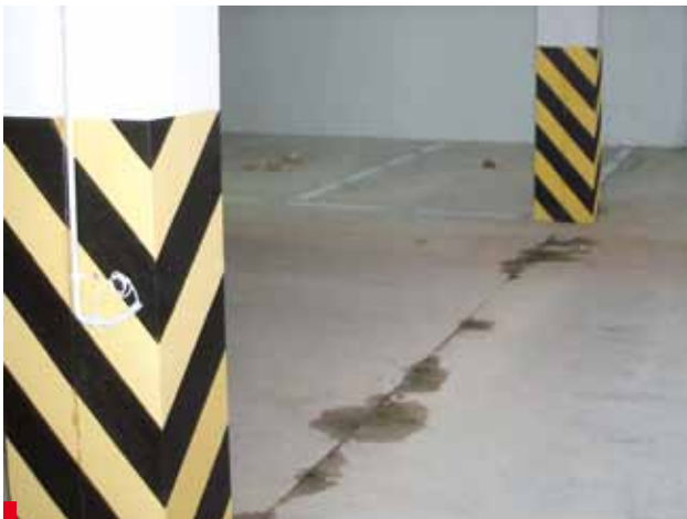
Fot. 5. Systemy hydroizolacji są bardzo zróżnicowane, ale niezależnie od zastosowanej technologii przecieki w następstwie błędów wyglądają zawsze tak samo
