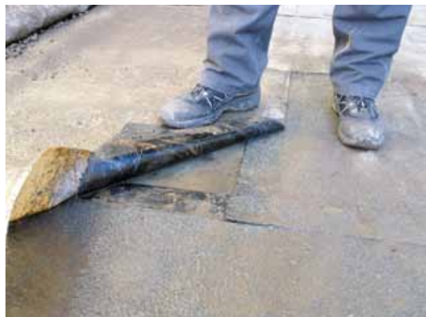
Fot. 7. To już nie jest błąd wykonawcy, ale jego kompromitacja
