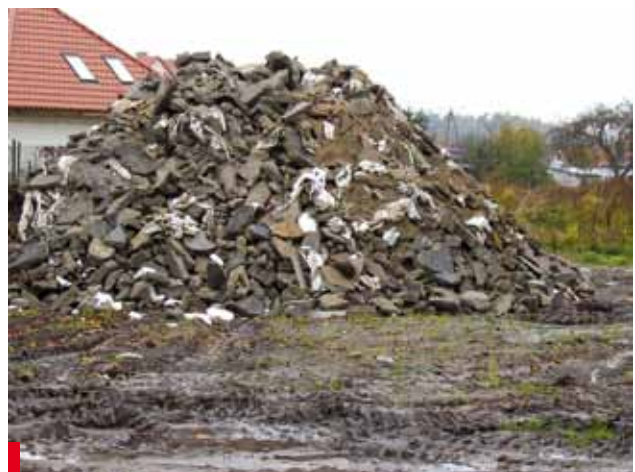
Fot. 26. Remont dachu użytkowego jest bardzo kosztowny również dlatego, że materiały zdemontowane wymagają utylizacji
