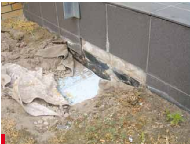
Fot. 3. Obróbka attyki z folii EPDM zakończona na wysokości nawierzchni dachu zielonego i nie uszczelniona
