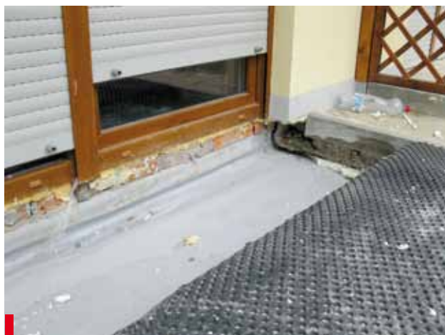
Fot. 2. Hydroizolacja dachu zielonego z folii PVC bez obróbki ściany na wymaganą wysokość
