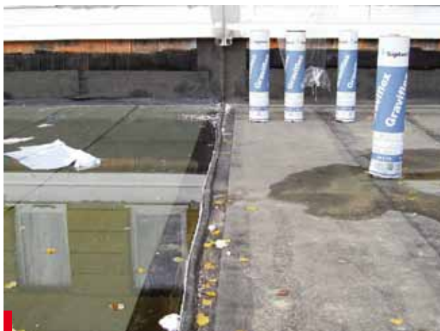
Fot. 17. Błąd wprowadzie wynika z projektu, ale obciąża również wykonawcę, który przed wykonaniem hydroizolacji powinien skorygować spadki do wpustów odwadniających i wtedy obróbka dylatacji dachu byłaby bezpieczna
