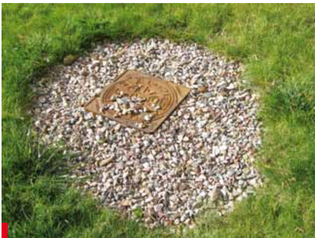
Fot. 23. ...jednak popełniono kolejny błąd, ponieważ studzienki są zamknięte żeliwną pokrywą, co uniemożliwia powierzchniowy spływ wody z dachu
