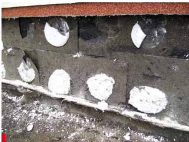
Fot. 1. Obróbka na ścianie budynku wykonana z odpadów papy, ale przecieki do wystąpiły na równie niechlujnie wykonanej połaci dachu zielonego
