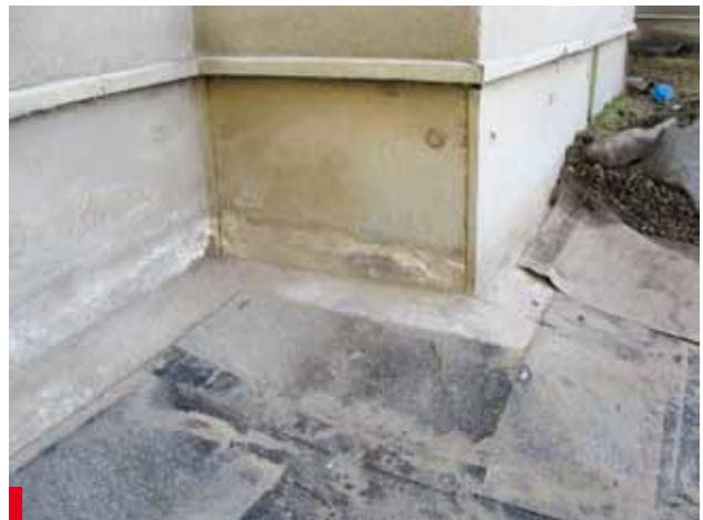
Fot. 16. Tego typu obróbka blacharska na dachu bitumicznym jest przejawem dekarzkiego zabobonu, czyli naiwnej wiary w nadzwyczajną moc blachy
